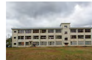
改修前の南側外観。ステールサッシの開閉もままならず、無断熱で過酷な環境だった。
