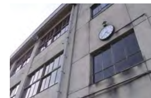
改修前の腐朽したステールサッシ。
